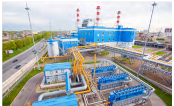
30 июня. Энергоснабжение центра Санкт-Петербурга © www.gazprom.ru
