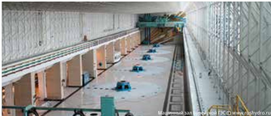
Машинный зал Бурейской ГЭС © www.rushydro.ru
