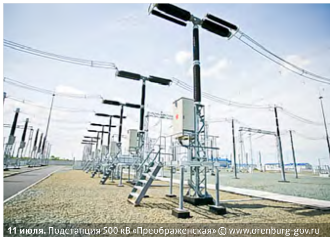
11 июля. Подстанция 500 кВ «Преображенская» © www.orenburg-gov.ru
