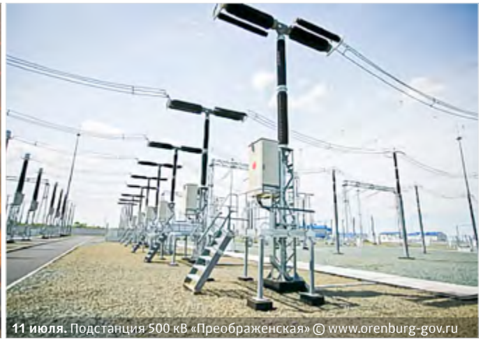
11 июля. Подстанция 500 кВ «Преображенская» © www.orenburg-gov.ru
