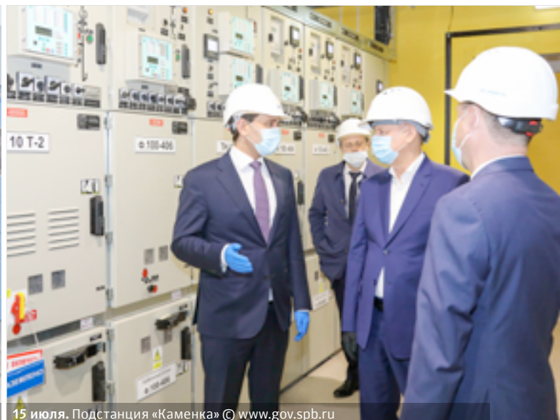
15 июля. Подстанция «Каменка» © www.gov.spb.ru
