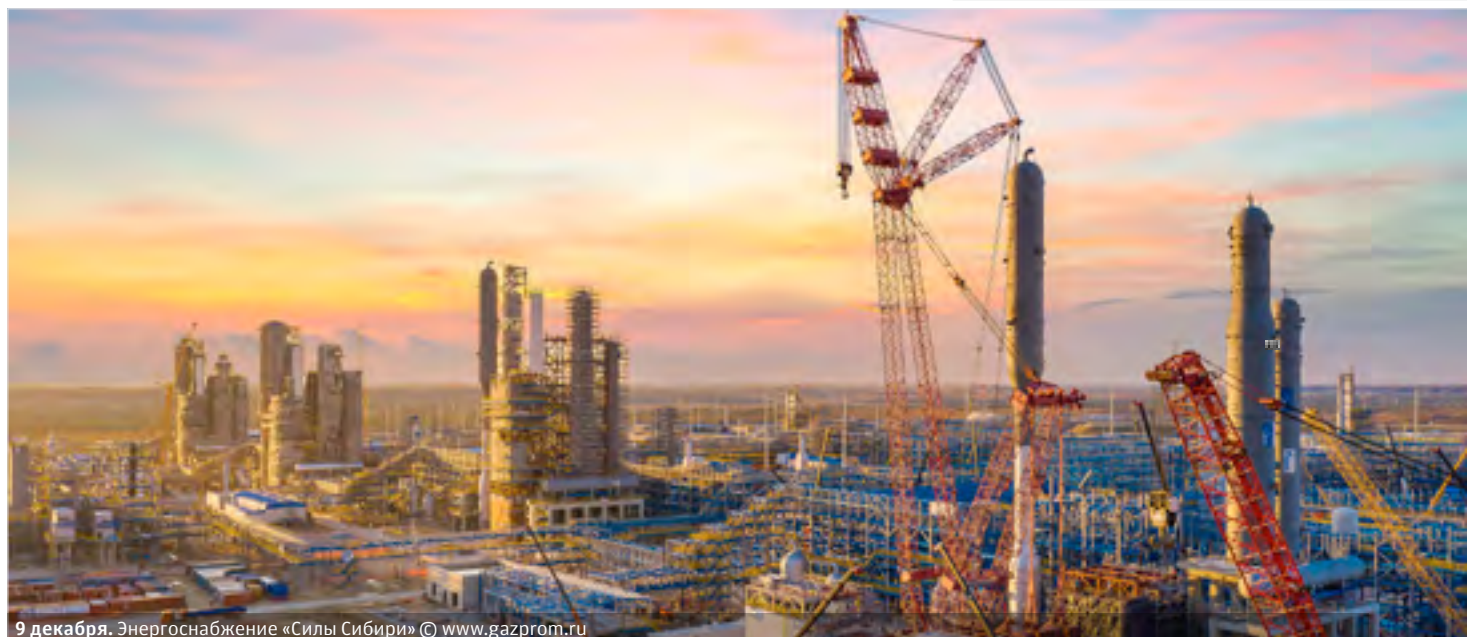
9 декабря. Энергоснабжение «Силы Сибири» © www.gazprom.ru
